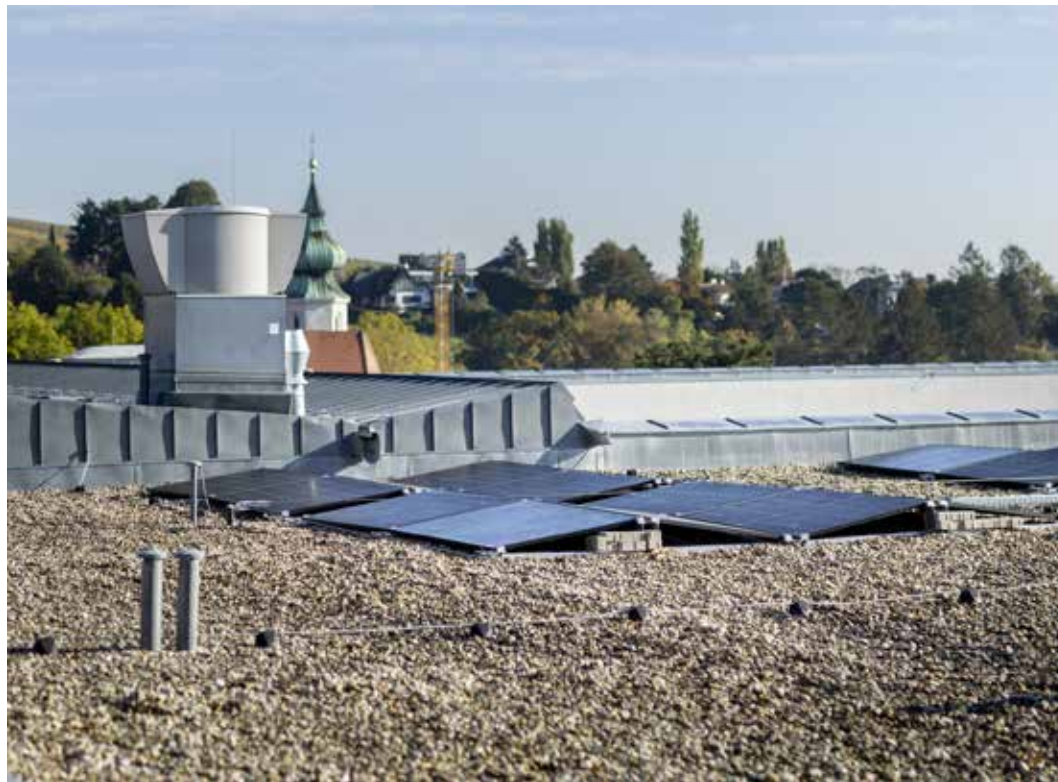
Im Rahmen des Photovoltaik-Ausbauprogramms werden die Dächer von Bundesschulen auf ihr Potenzial für Solaranlagen geprüft, um den Energiebedarf nachhaltig und kostengünstig mit erneuerbarer Energie zu decken.
